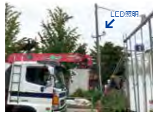
仮設照明のLED化
